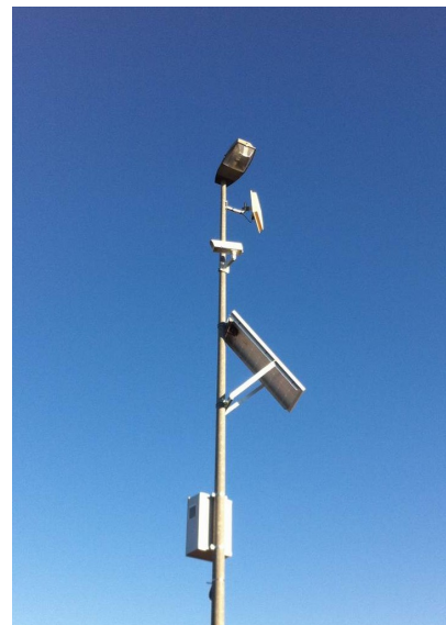
CPEs instalados para la videovigilancia
