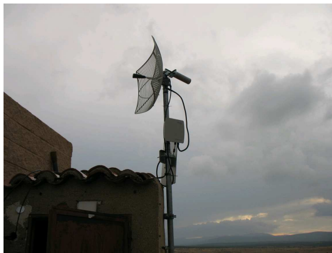
Repetidor WiMAX para proporcionar cobertura a Campisábalos
